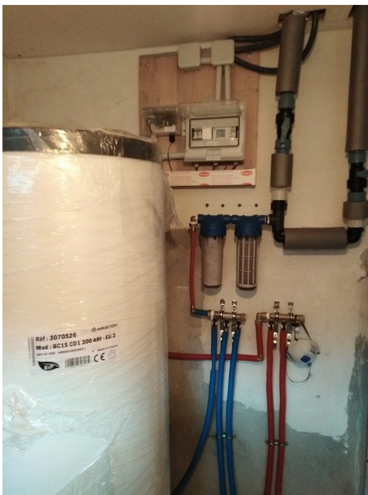
Vista general del acumulador y panel eléctrico
