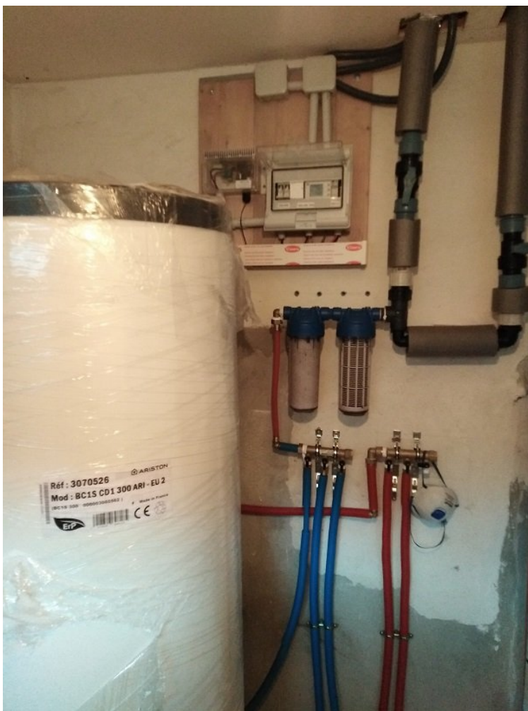
Vista general del acumulador y panel eléctrico
